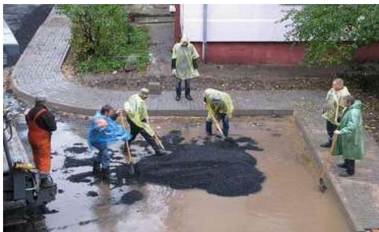
Рисунок 2 – Пример грубого нарушения технологии укладки асфальта
